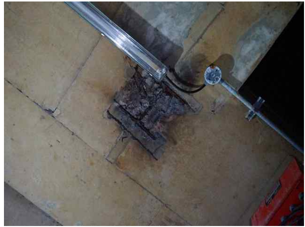
펌프실 S003 슬래브 철근노출
