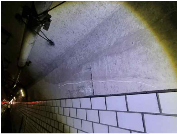
본선 NATM구간 측벽부 S399 균열( C_w=0.3\text{mm} )
