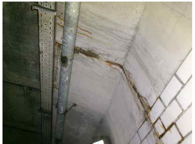
본선 NATM구간 측벽부 S127 균열(Cw=0.3mm) 및 누수(떨어짐)
