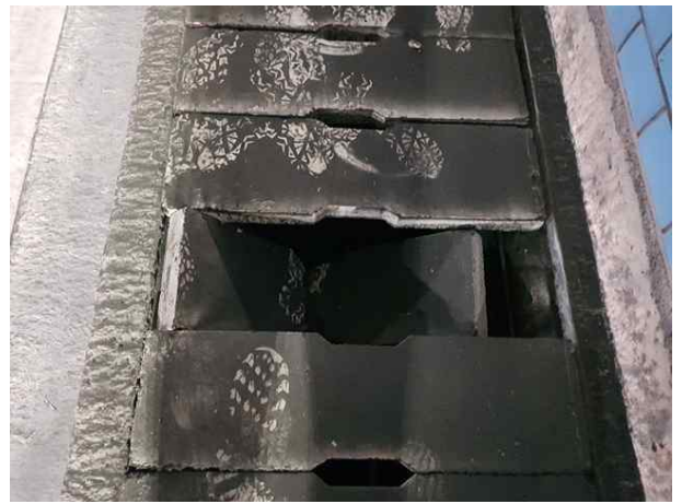
본선 공동구 S611 덮개파손
