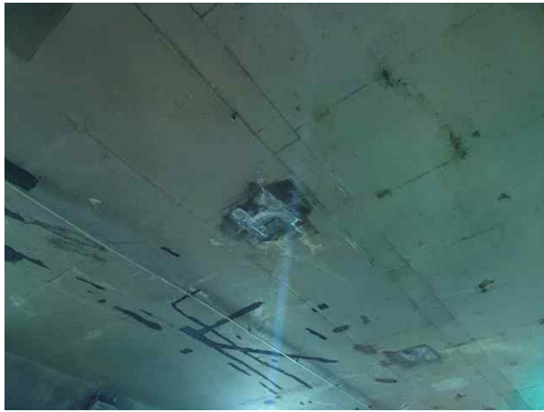
RAMP-D BOX구간 슬래브 S57 백태
