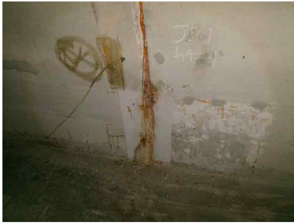
RAMP-D NATM구간 측벽부 S35 누수(스며있음)
