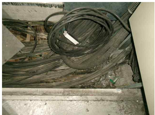
RAMP-D 전기실 트레이 내부 채수
