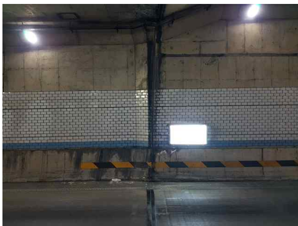
본선 BOX구간 벽체 S710 균열( Cw=0.3mm ) 및 누수(스며있음)
