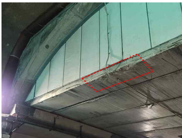
RAMP-D 풍도슬래브 S54 하면 파손
