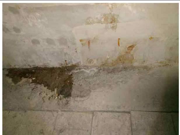
RAMP-D NATM구간 측벽부 S30 균열( C_w=0.3\text{mm} ) 및 누수(스며있음)
