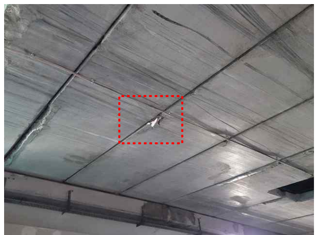
RAMP-D 풍도슬래브 S54 하면 보수부 파손
