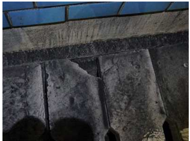
본선 공동구 S258 덮개파손
