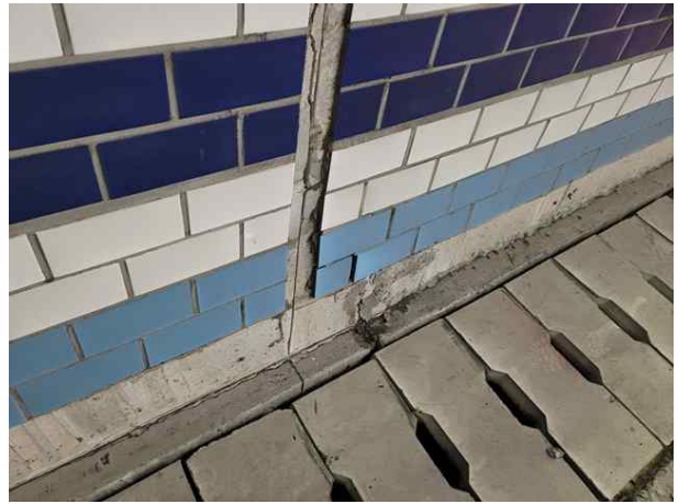
RAMP-D NATM구간 측벽부 S40 파손
