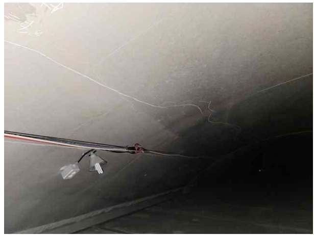
RAMP-D NATM구간 천단부 S03 균열(Cw=0.5mm)
