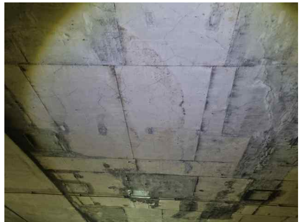
본선 BOX구간 슬래브 S705 망상균열
