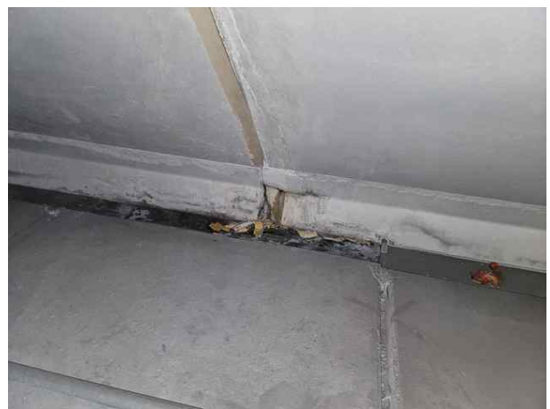
본선 NATM구간 천단부 S127 균열( C_w=0.3\text{mm} ) 및 누수(스며있음)
