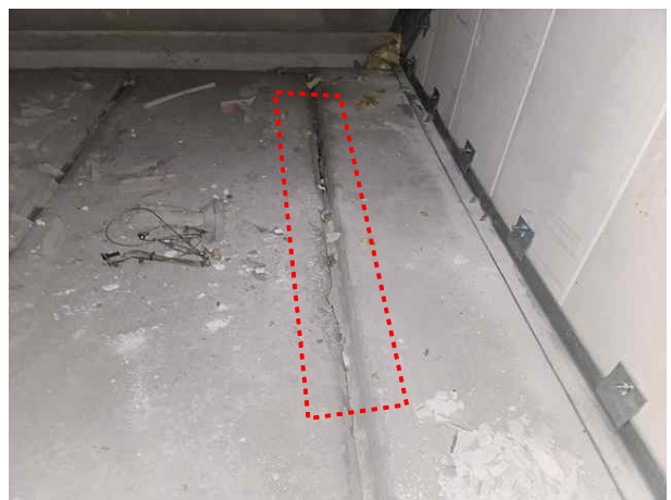
RAMP-D 풍도슬래브 S54 상면 파손
