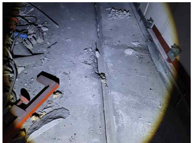
RAMP-D 풍도슬래브 S54 상면 파손
