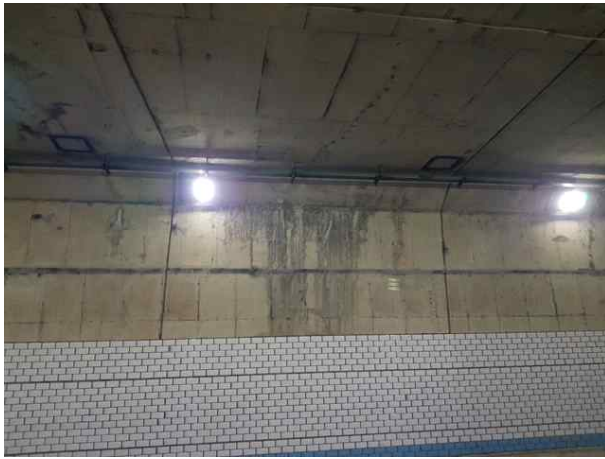
본선 BOX구간 벽체 S711 균열( Cw=0.3mm ) 및 누수(스며있음)
