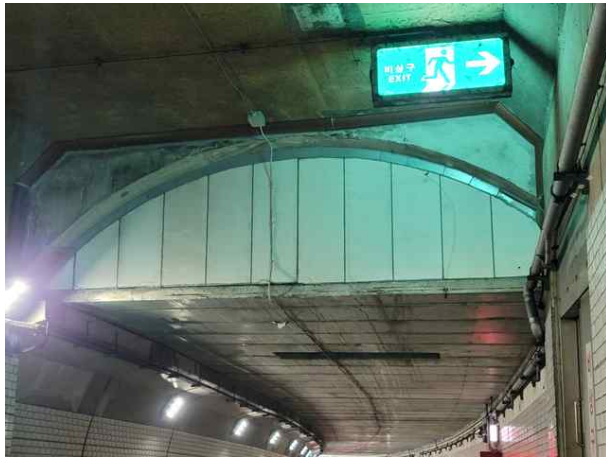
RAMP-D 풍도슬래브 S54 격벽 파손 및 철근노출 보수양호
