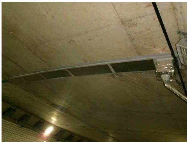
본선 BOX구간 슬래브 S003 누수보수 양호
