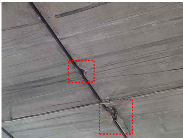
RAMP-D 풍도슬래브 S54 하면 파손
