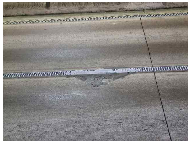
본선 포장부 S623 보수부 파손
