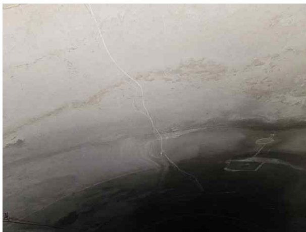
RAMP-D NATM구간 천단부 S06 균열(Cw=0.5mm)
