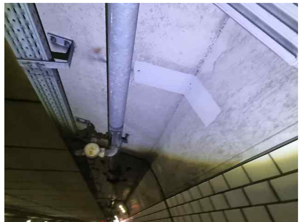
본선 NATM구간 측벽부 균열보수 양호
