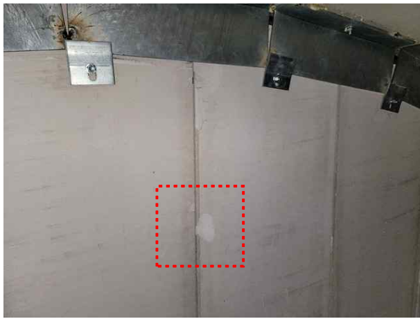
RAMP-D 풍도슬래브 S54 격벽 파손
