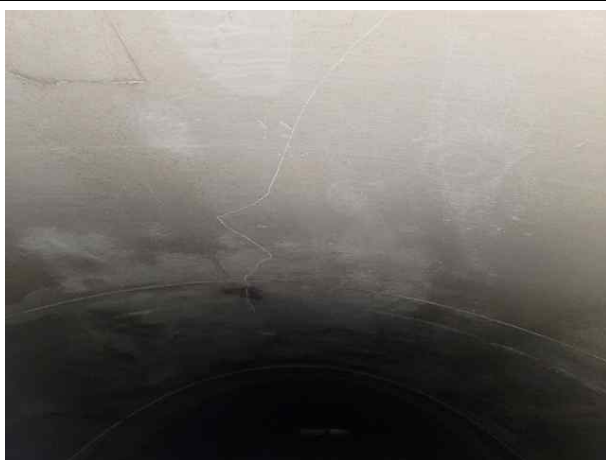
RAMP-D NATM구간 천단부 S10 균열(Cw=0.5mm)
