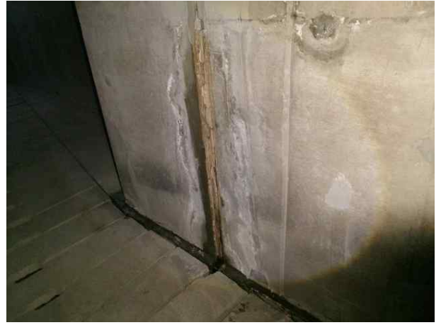
RAMP-D BOX구간 벽체 S58 누수(스며있음)
