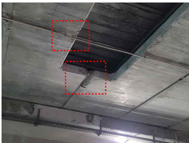
RAMP-D 풍도슬래브 S53 하면 파손
