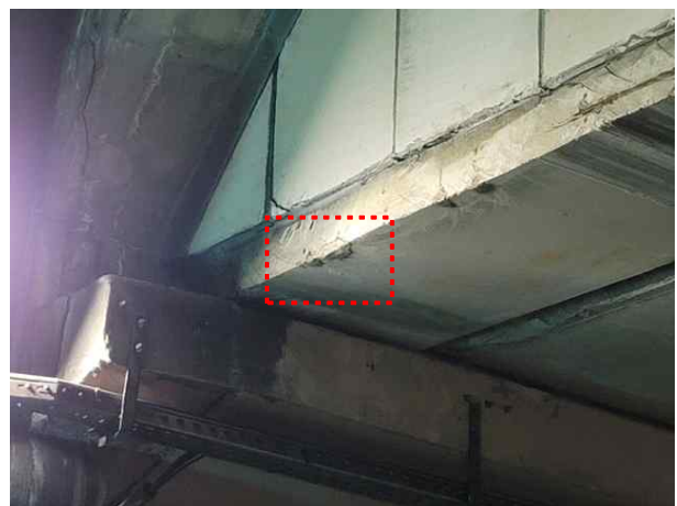
RAMP-D 풍도슬래브 S54 하면 파손
