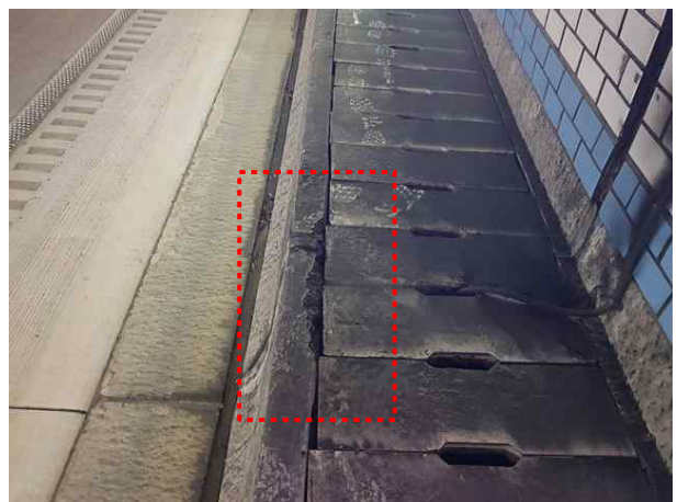
본선 공동구 S391 덮개파손
