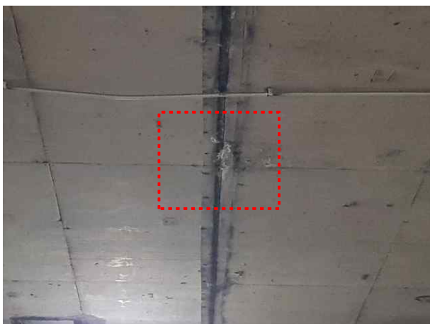
본선 BOX구간 슬래브 S710 백태
