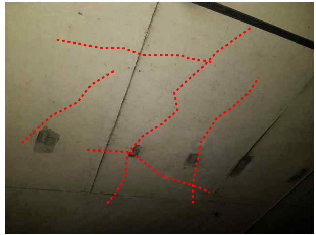
본선 BOX구간 슬래브 S715 망상균열
