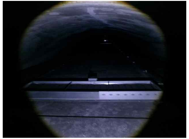
본선 NATM구간 풍도슬래브 댐퍼 전경
