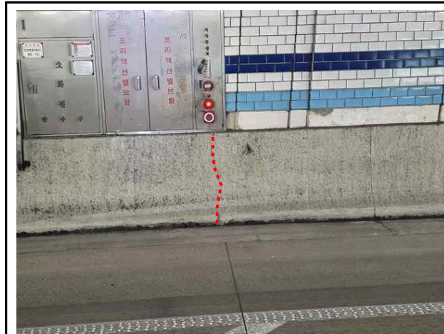
RAMP-D 공동구 S24 균열(Cw=0.3mm)
