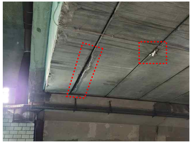
RAMP-D 풍도슬래브 S54 하면 보수부 파손
