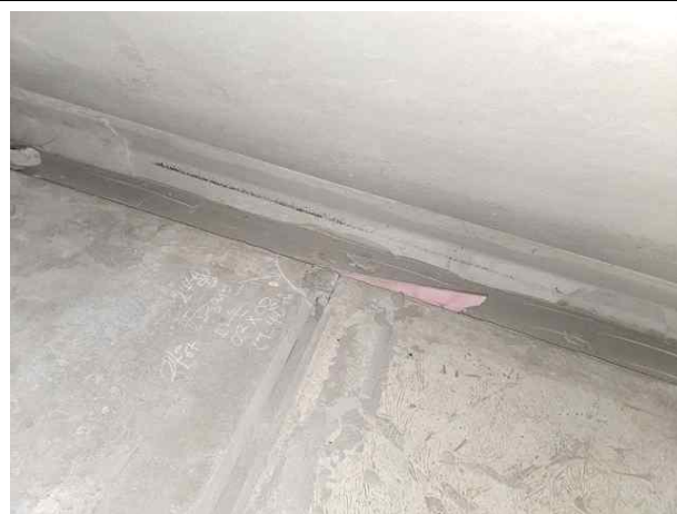
RAMP-D 풍도슬래브 S53 상면 파손
