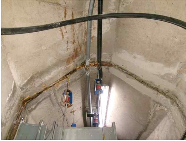
RAMP-D BOX구간 벽체 S57 누수(떨어짐)
