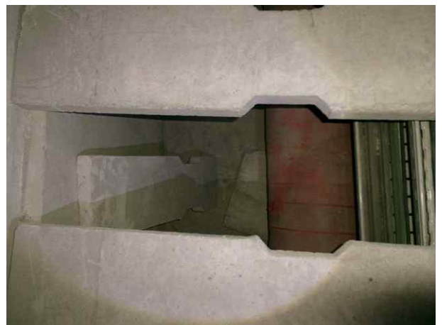
RAMP-D 공동구 S57 덮개파손
