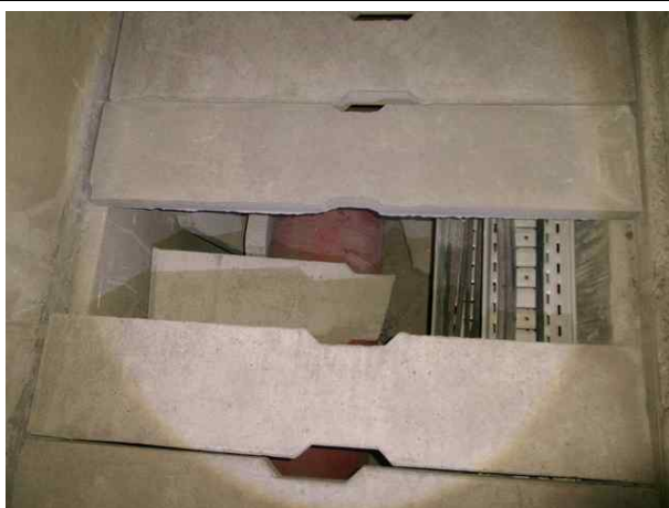
RAMP-D 공동구 S58 덮개파손
