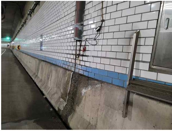
RAMP-D 배수시설 S57 유도배수관 길이부족
