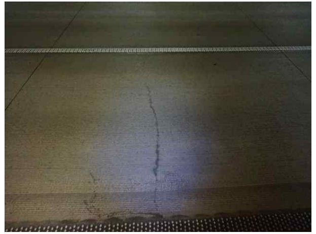
본선 포장부 S074 균열
