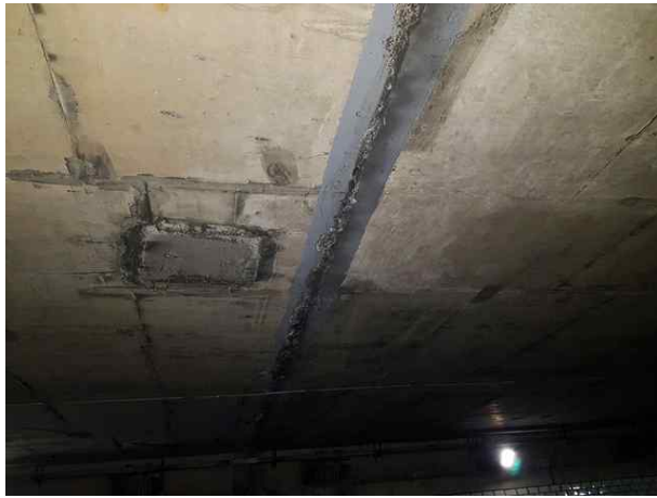
본선 BOX구간 슬래브 S714 누수(떨어짐)
