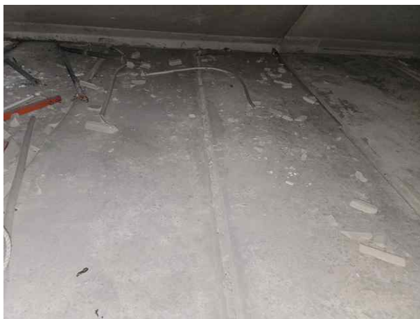
RAMP-D 풍도슬래브 S54 상면 물탈파손
