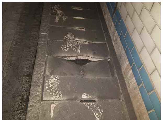
본선 공동구 S701 덮개파손
