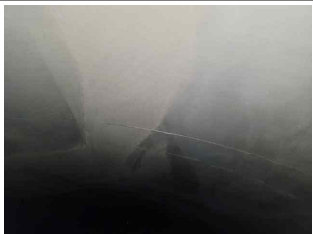
RAMP-D NATM구간 천단부 S13 균열(Cw=0.3mm)
