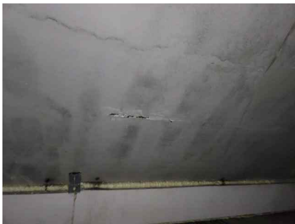
본선 NATM구간 천단부 S084 철근노출
