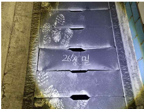
본선 공동구 S624 덮개파손
