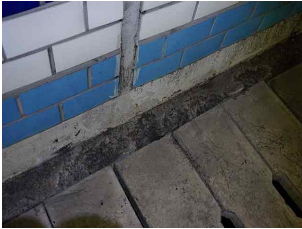
본선 공동구 S015 파손
