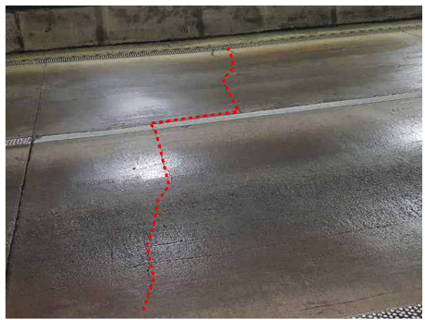
본선 포장부 S704 균열
