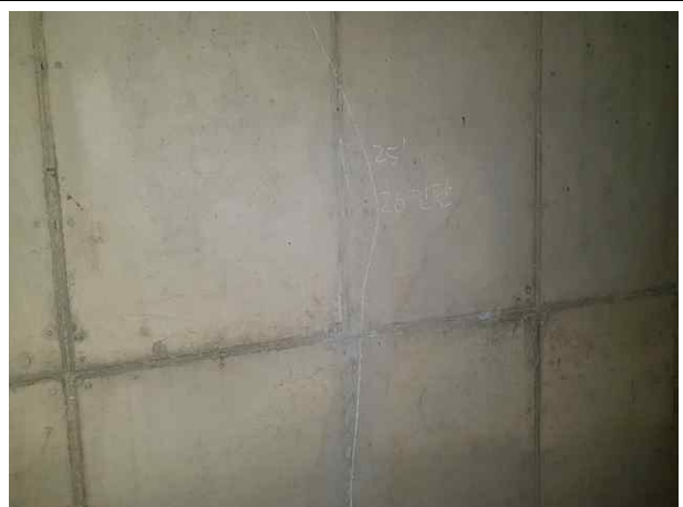
RAMP-D 수문 벽체 균열(Cw=0.2mm)
