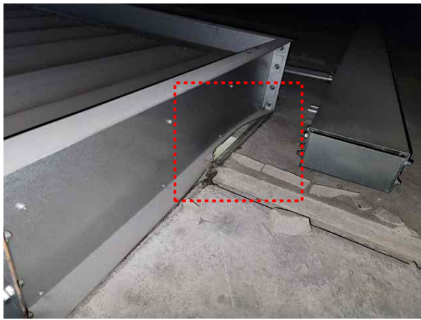
RAMP-D 풍도슬래브 S53 댐퍼 변형
