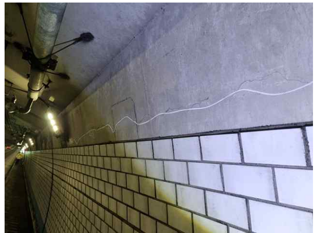
본선 NATM구간 측벽부 S628 균열( C_w=0.2\text{mm} )
