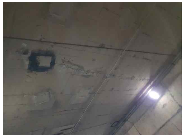
본선 BOX구간 슬래브 S711 균열( Cw=0.3mm ) 및 누수(스며있음)
