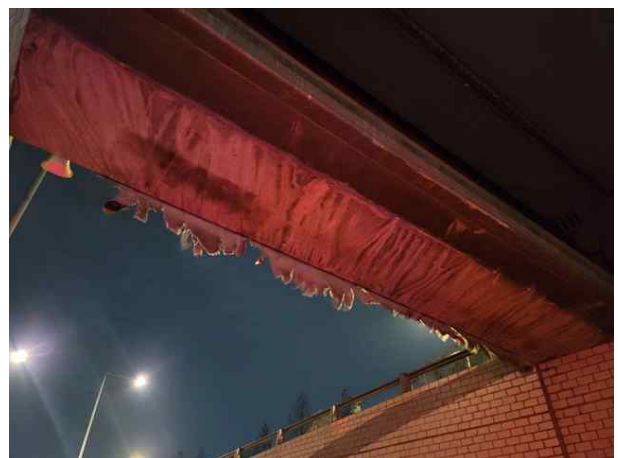
RAMP-D BOX구간 슬래브 S60 백태
