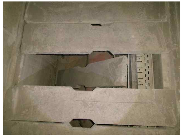
RAMP-D 공동구 S55 덮개파손
