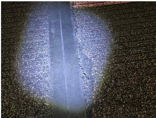
진입부 U-TYPE 옹벽 S2 포장 파손
