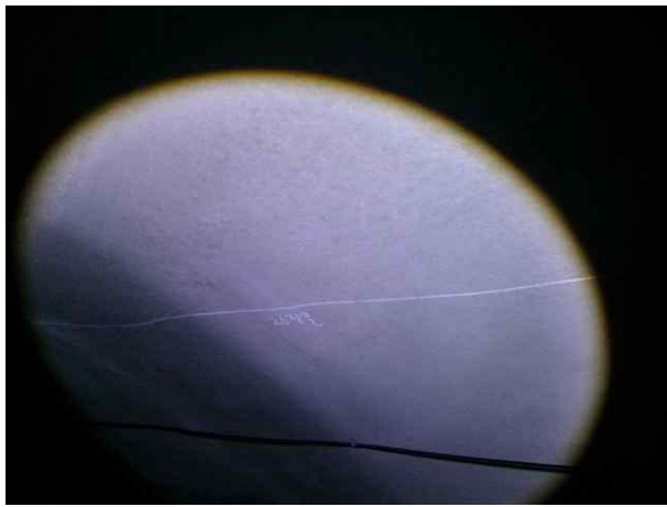
본선 NATM구간 천단부 S421 균열(Cw=0.5mm)
