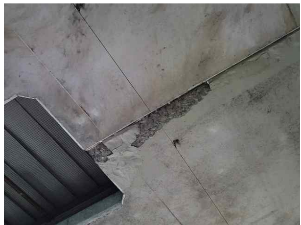
RAMP-D 풍도슬래브 S53 하면 보수부 파손
