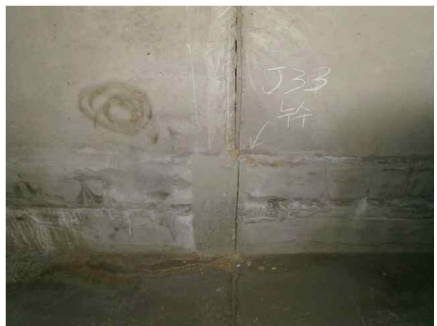
RAMP-D NATM구간 측벽부 누수보수 양호
