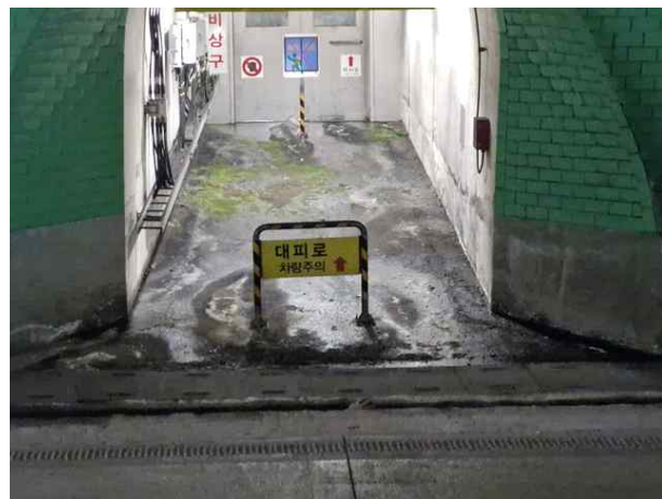
피난연락갱 S057 누수(떨어짐)
