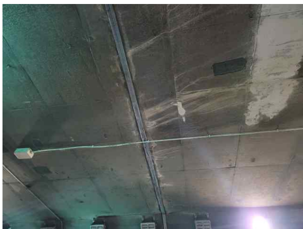
RAMP-D BOX구간 슬래브 S59 누수(스며있음)
