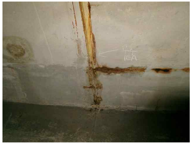
RAMP-D NATM구간 측벽부 S14 누수(스며있음)
