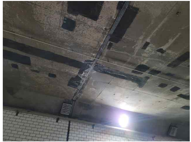
RAMP-D BOX구간 슬래브 S58 누수(떨어짐)
