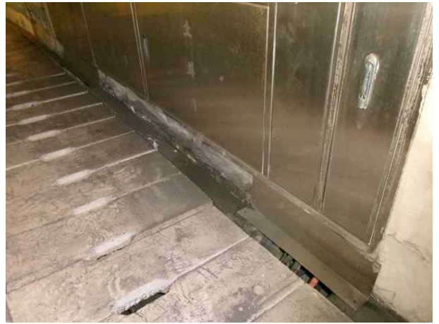
본선 NATM구간 측벽부 S087 균열(Cw=0.3mm) 및 누수(스며있음)
