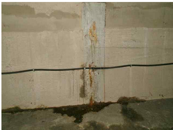
RAMP-D 전기실 벽체 균열 및 누수
