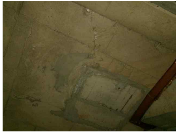
본선 BOX구간 슬래브 S006 균열부백태
