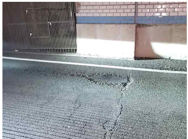
RAMP-D 진입부 U-TYPE 옹벽 S5 포장 파손
