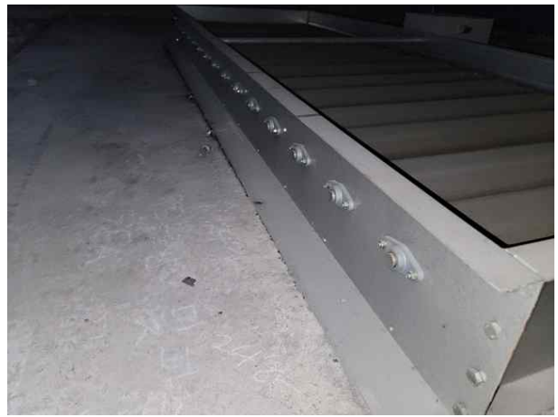
RAMP-D 풍도슬래브 S53 댐퍼 볼트탈락 및 파손
