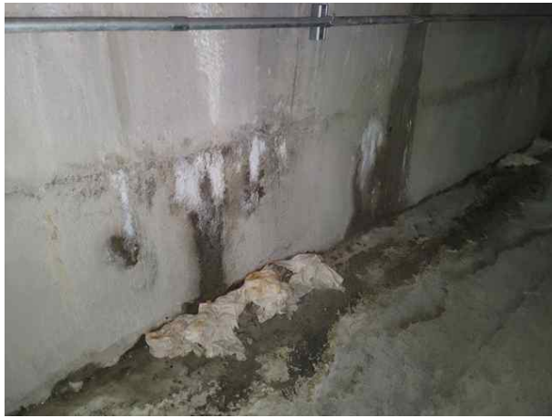
RAMP-D 전기실 벽체 균열 및 누수
