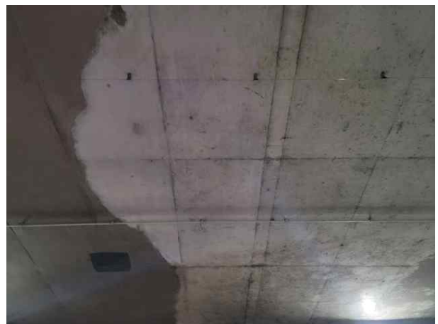
RAMP-D BOX구간 슬래브 S58 망상균열( C_w=0.1\sim0.2\text{mm} )
