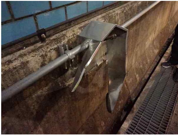
진입부 U-TYPE 옹벽 S4 단자합 파손
