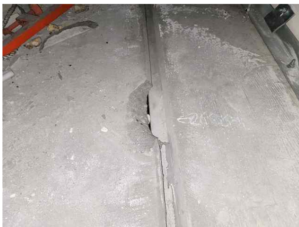
RAMP-D 풍도슬래브 S54 상면 파손
