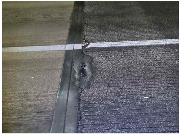
진입부 U-TYPE 옹벽 S1 포장 파손
