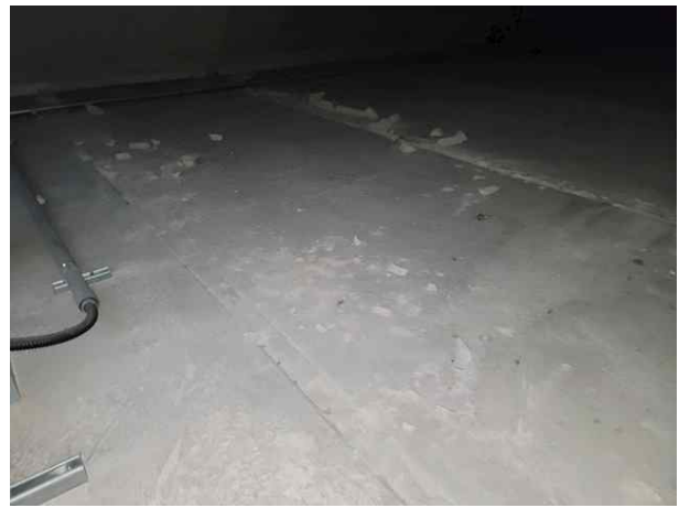
RAMP-D 풍도슬래브 S53 상면 몰탈파손
