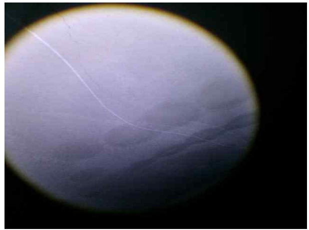
본선 NATM구간 천단부 S498 균열(Cw=0.5mm)
