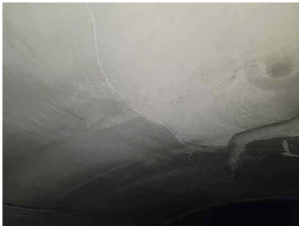
RAMP-D NATM구간 천단부 S02 균열(Cw=0.5mm)
