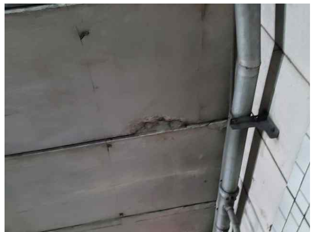
RAMP-D 풍도슬래브 S54 하면 파손
