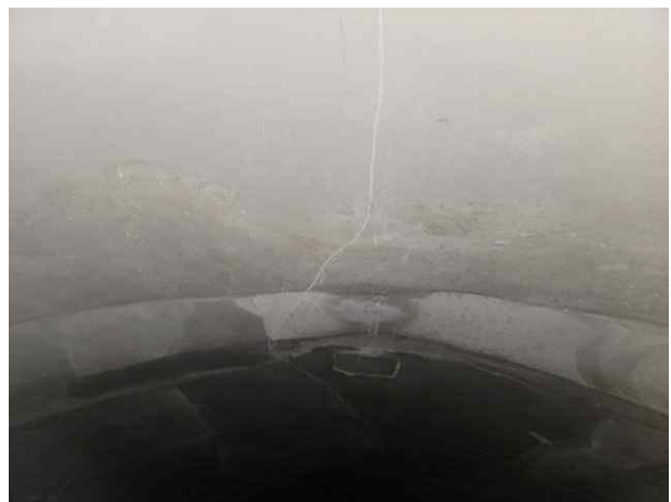
RAMP-D NATM구간 천단부 S07 균열(Cw=0.5mm)
