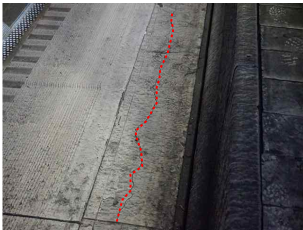
본선 포장부 S344 파손
