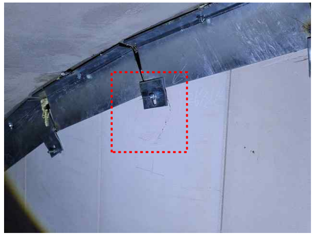
RAMP-D 풍도슬래브 S54 격벽 파손
