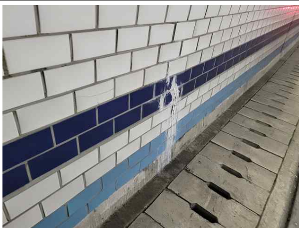
RAMP-D NATM구간 측벽부 S29 백태
