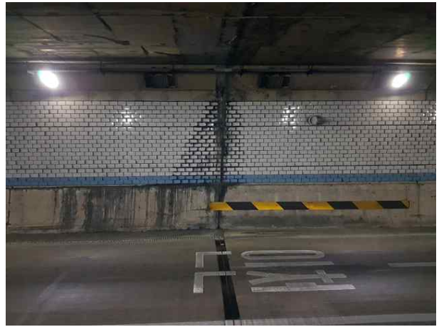
본선 BOX구간 벽체 S713 누수흔적
