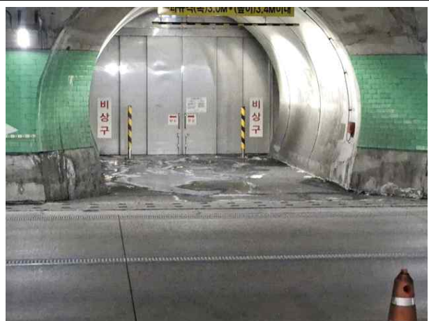
피난연락갱 S144 누수(떨어짐)
