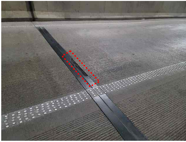
RAMP-D 포장부 S58 로드셀 파손
