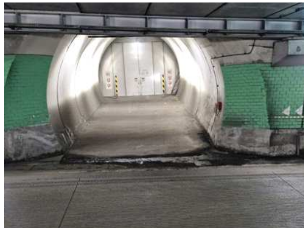
피난연락갱 S039 누수(떨어짐)
