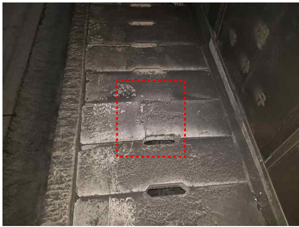
본선 공동구 S435 덮개파손
