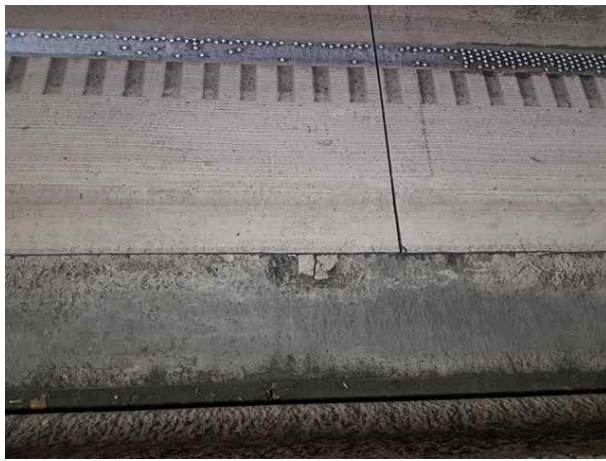
본선 포장부 S467 파손
