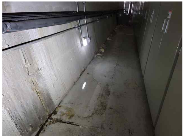
RAMP-D 전기실 바닥 채수
