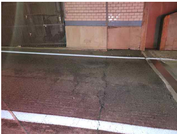
RAMP-D 진입부 U-TYPE 옹벽 S5 포장 균열
