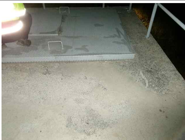
RAMP-D 수문 상부슬래브 표면열화
