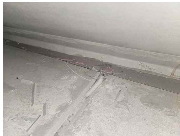
RAMP-D 풍도슬래브 S53 상면 파손
