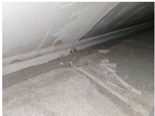
RAMP-D 풍도슬래브 S53 상면 파손
