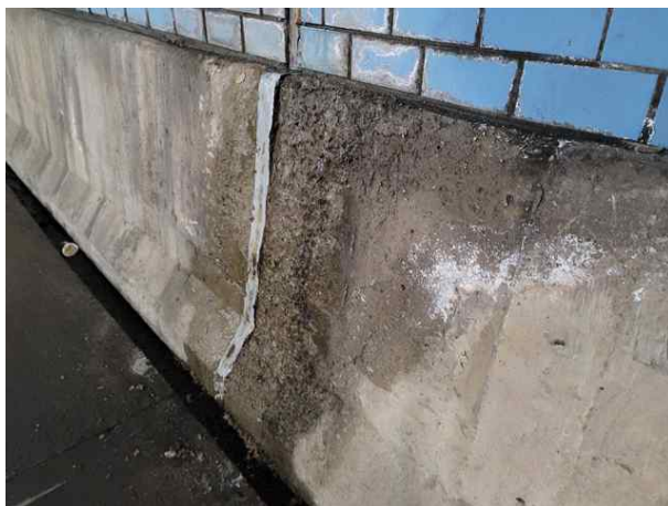
RAMP-D 공동구 S57 박리
