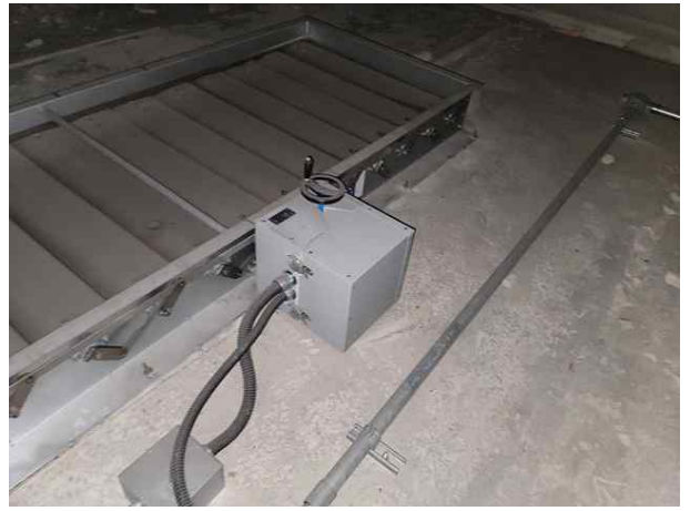
RAMP-D 풍도슬래브 S53 덮개탈락 및 파손 보수양호
